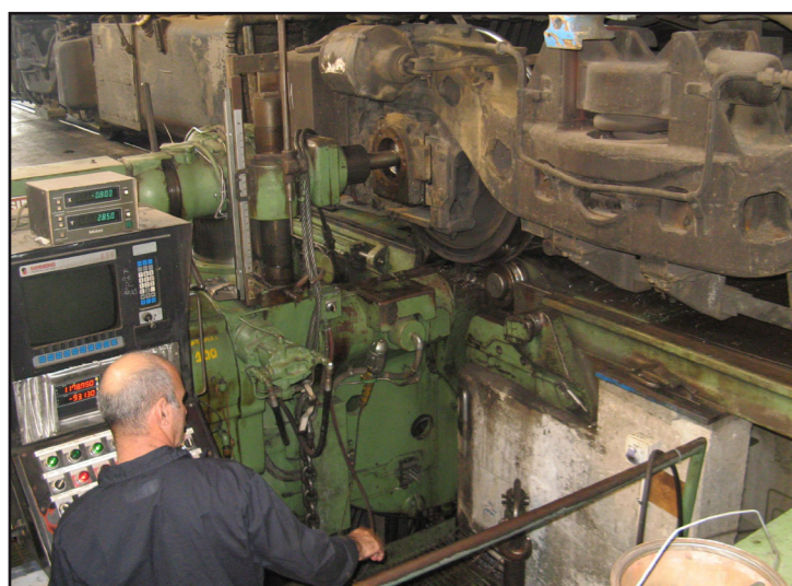
Обработка на подрельсовом станке для восстановления профиля колес локомотива без их снятия.
